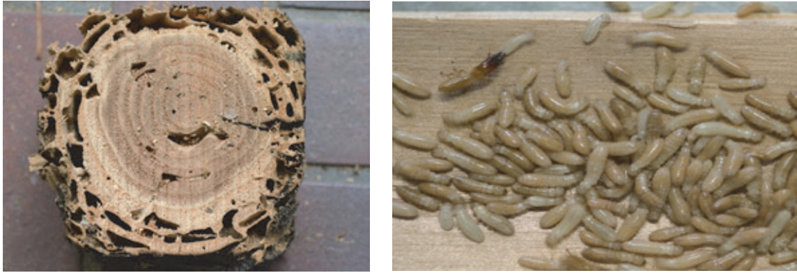
写真 5 : アメリカカンザンシロアリ被害材断面 (左) と材より取り出したコロニー (右)
