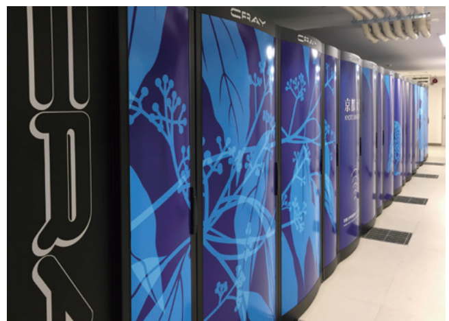
平成28年度に更新したA-KDK(システムA)の概観
