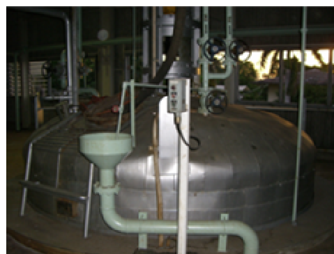
写真5 エタノール製造プラントの発酵タンク
