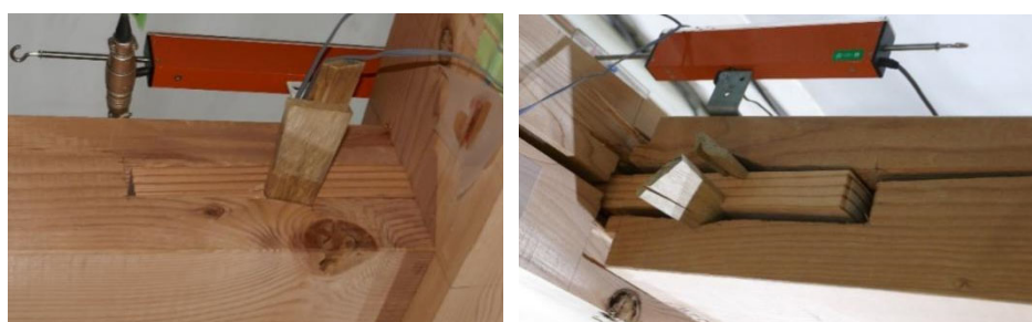
(d) 車知接合部の変形
