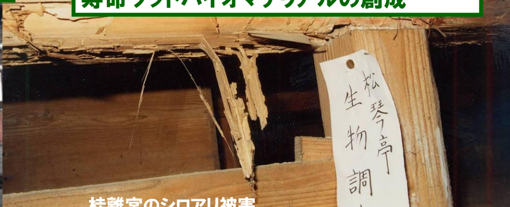
桂離宮のシロアリ被害
